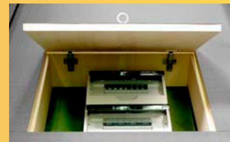
Quadro elettrico generale e di sezionamento
